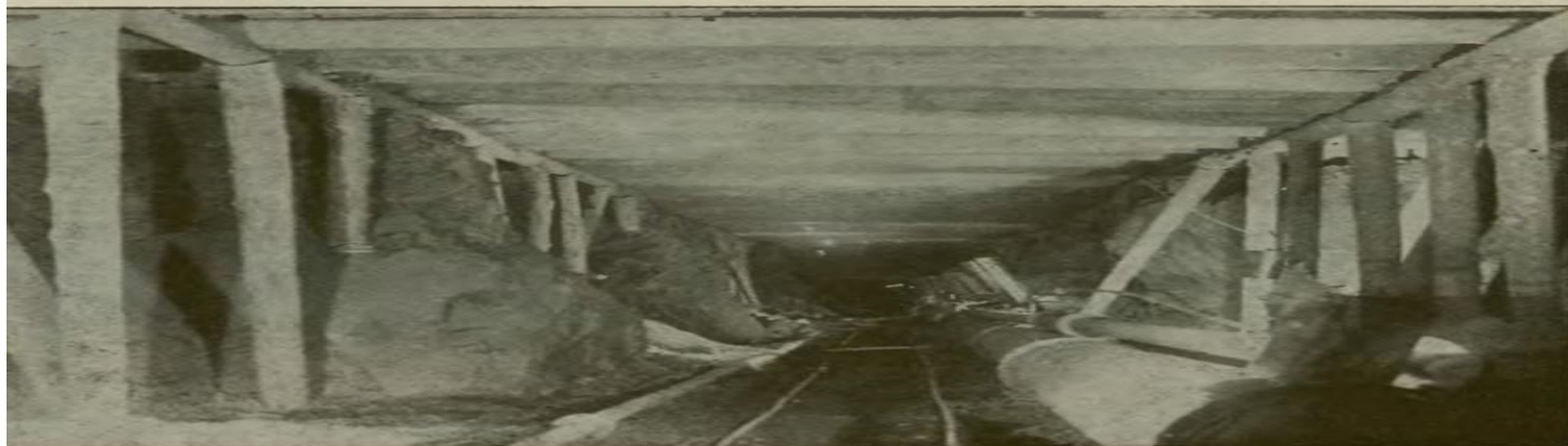
Grande Galleria dell'Appennino - Cantiere dei pozzi inclinati di Ca' di Landino Attacco verso Bologna dal pozzo n. 1 - Cantiere dei piedritti.
